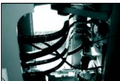
Boca de medidas de presión
