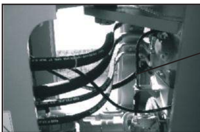
Boca de medidas de presión
